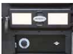
Regulador aire combustión y termostato bomba
